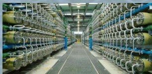
海水淡水化プラント
