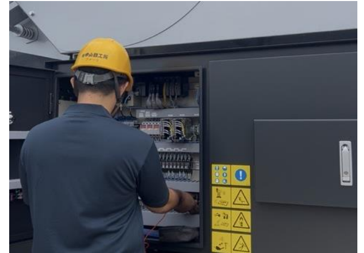
試運転・制御盤確認
