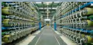
海水淡水化プラント
