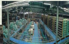
②海水淡水化施設
