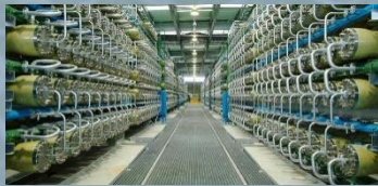
海水淡水化プラント
