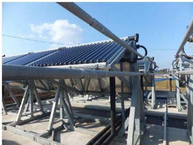
真空管式集熱器(角度調整架台)
