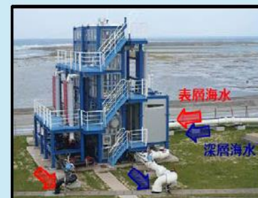
海洋温度差発電 （提供：佐賀大学）
