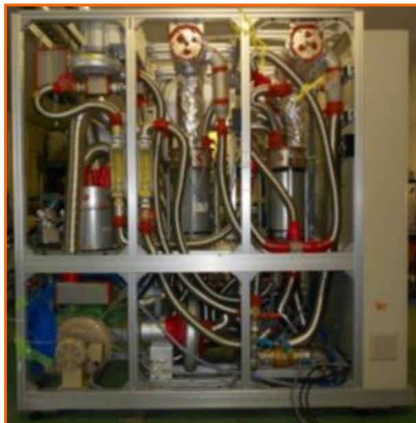
二酸化炭素分離回収装置
