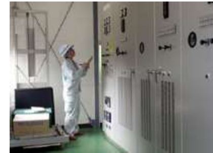
電機設備点検
