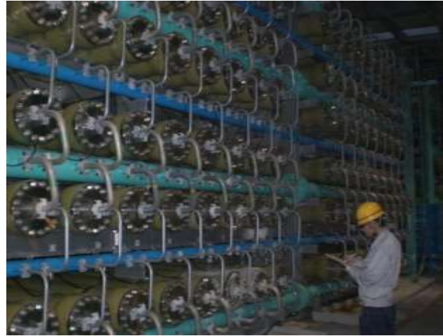
海水淡水化施設維持管理
