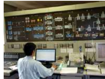
浄水場維持管理
