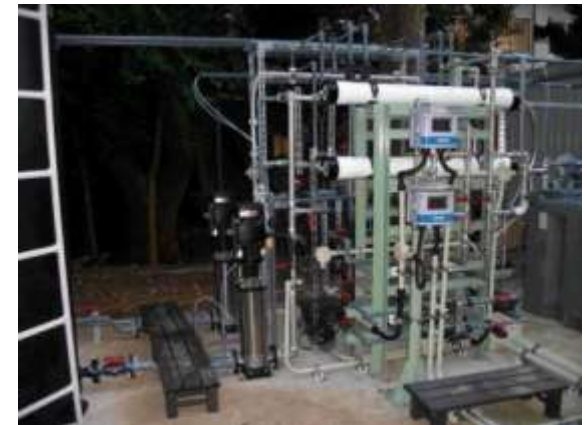
排水再利用実験設備
