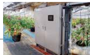
ハウス栽培システム制御盤
