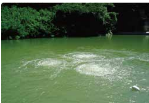
装置運転状況
