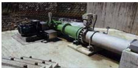
小水力発電 導入事例 (水車仕様：クロスフロー水車)
