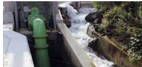
小水力発電 導入事例 (水車仕様：横軸プロペラ水車)
