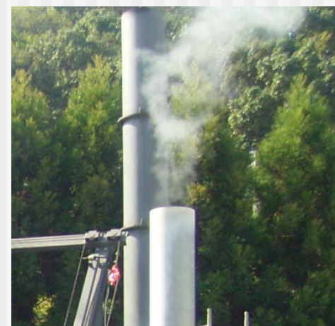
蒸気発生状況
