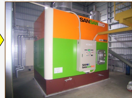
バイオマスボイラ
