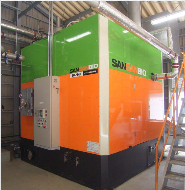
バイオマスボイラ
