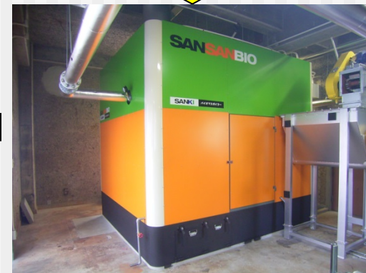
バイオマスボイラ 17
