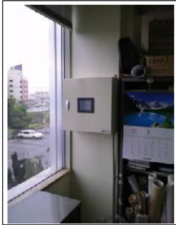
本体設置状況
