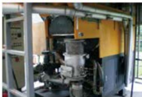
温水ボイラーで燃焼
