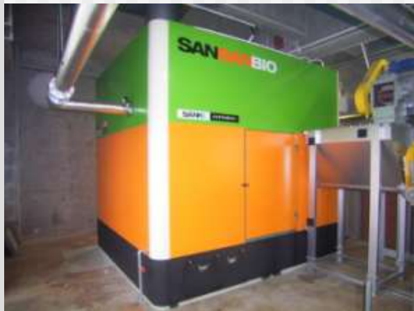
温浴施設に給湯
