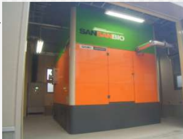
バイオマスボイラ
